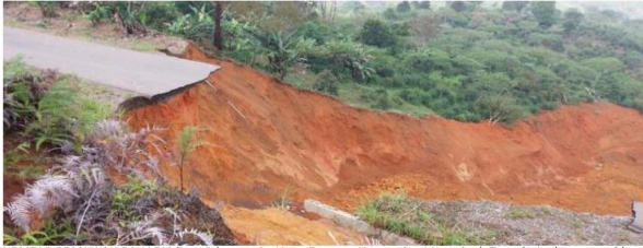
KOMPAS.COM/IWAN BAHAGIA Ruas jalan provinsi Isaq-Peregen, Kecamatan Lings, Aceh Tengah, Aceh, yang amblas akibat hujan deras yang mengguyur daerah itu beberapa hari ini.
